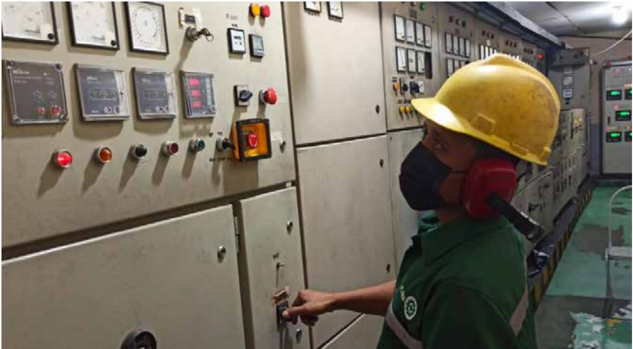
Gambar 8.4. Penggunaan energi listrik di PKS yang bersumber dari bahan bakar biomassa
